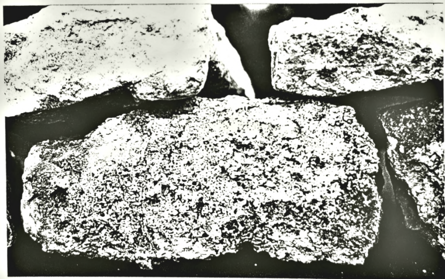
Trou N° 2 - Moellons de calcaire dégradés par les lithophages
