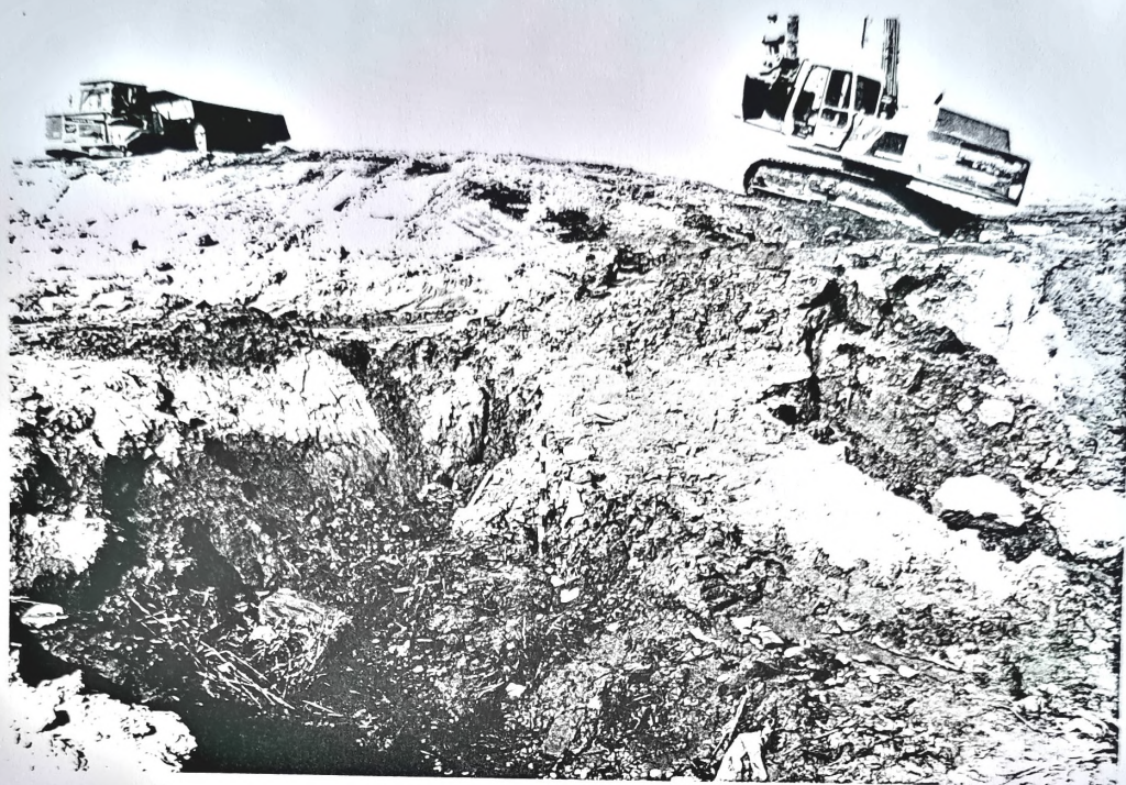
n° 1 : éboulis le long de la paroi
